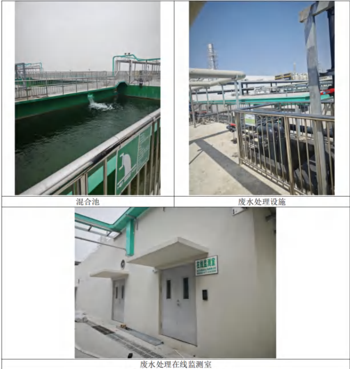
图 4.1-2 废水治理设施现场图
