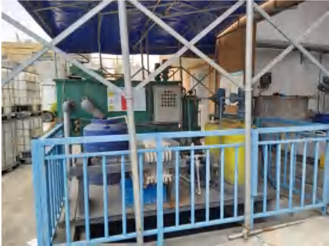
图 3.3-2 现有废水处理装置
