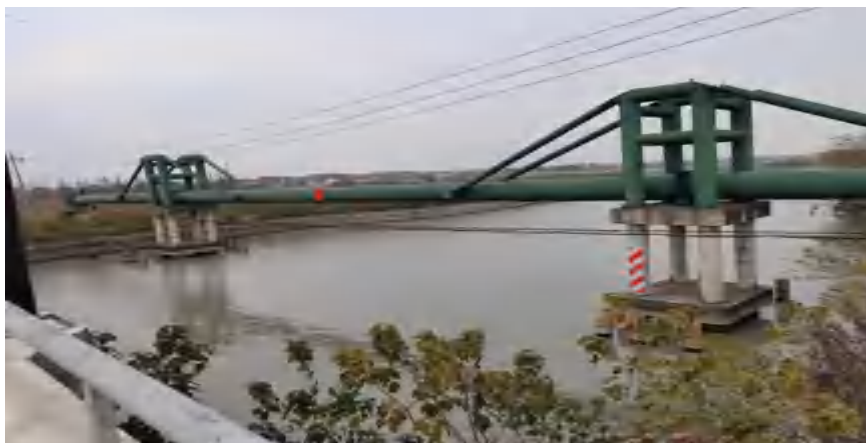
图 3.2-12 支柱式架空管
