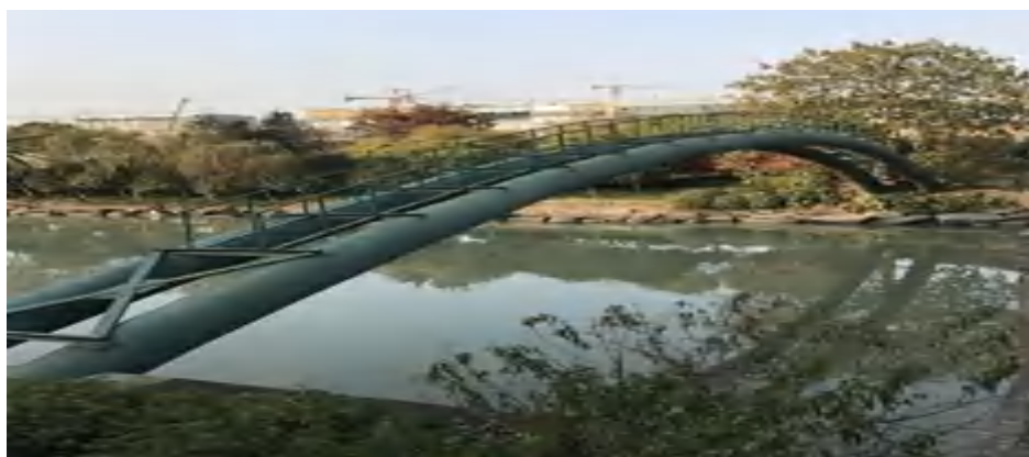
图 3.2-13 支柱式架空管
