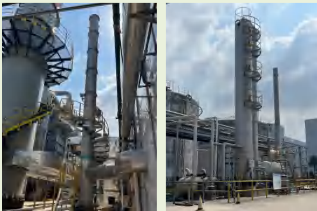
a. 有机废气 RTO 设施
